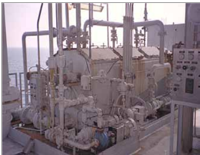
شکل ۲ | واحد شناورسازی در یک سکوی دریایی [۶]
