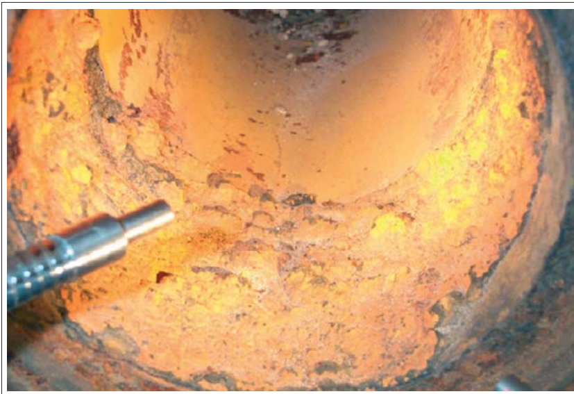
شکل ۵ | لایه های چسبیده به سطح داخلی لوله
