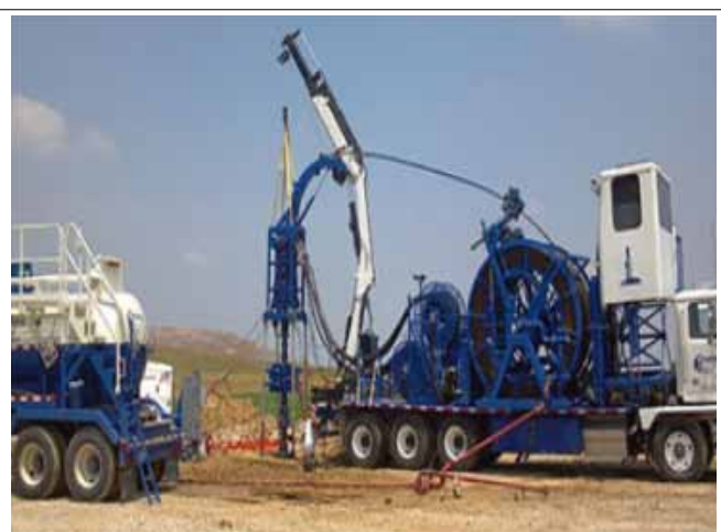
شکل ۶ | دستگاه پمپ تراک در کنار لوله مغزی سیال جهت انجام پمپاژ سیال به داخل چاه
