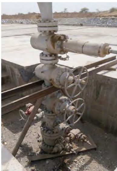
شکل ۳ | نشست تاج چاه
