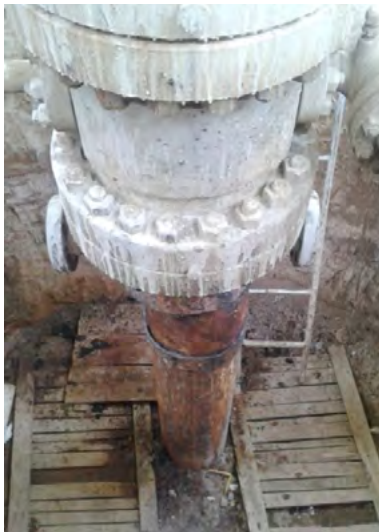
شکل ۱۵ | نشست تاج چاه به سمت چپ
